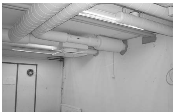
Tietotalo 2:een rakennettu väestönsuojatila tulee Blankon käyttöön. Katossa on – tietysti – nykyisestä kiltahuoneestakin jo kovin tutut ilmastointiputket.
